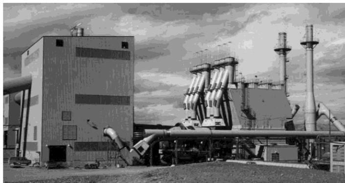
Рис. 4.1.7.1. Сушильная установка с газоочистными сооружениями на обогатительной фабрике для энергетических углей. Канада
